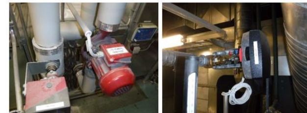
Kuvat 11 a ja b. LTO- ja jälkilämmityspattereissa ei havaittu aistinvaraisen arvion perusteella poikkeavia ääniä. Yksittäisissä jälkilämmityspattereiden moottoriventtiileissä havaittiin sivuääniä, esimerkikuvassa TK 17.
