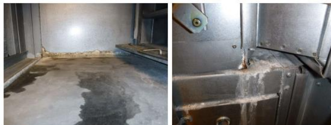
Kuva 5 a ja b. Rakennusosalla F sijaitsevien keittiön ja ruokasalin ilmanvaihtokoneissa havaittiin kosteusjälkiä sekä korroosiovaurioita.
