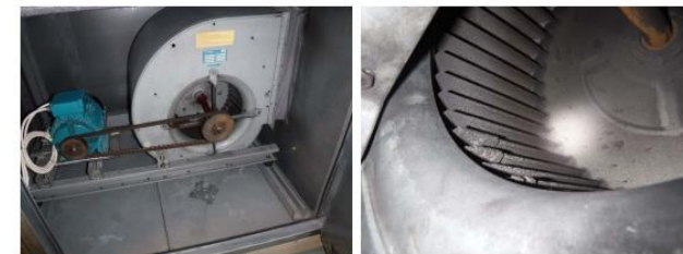
Kuva 10 a ja b. Ilmanvaihtokoneiden puhaltimet ovat hihnaveisia kammiopuhaltimia. Puhaltimien käyntiäänissä ei havaittu aistinvaraisen arvion perusteella poikkeavaa ääntä ja käyttöihnnat olivat tarkastetuilta osin hyväkuntoisia. Tulo- ja poistoilmapuhaltimien siivekkeissä havaittiin pinttynyttä likakertymää.
